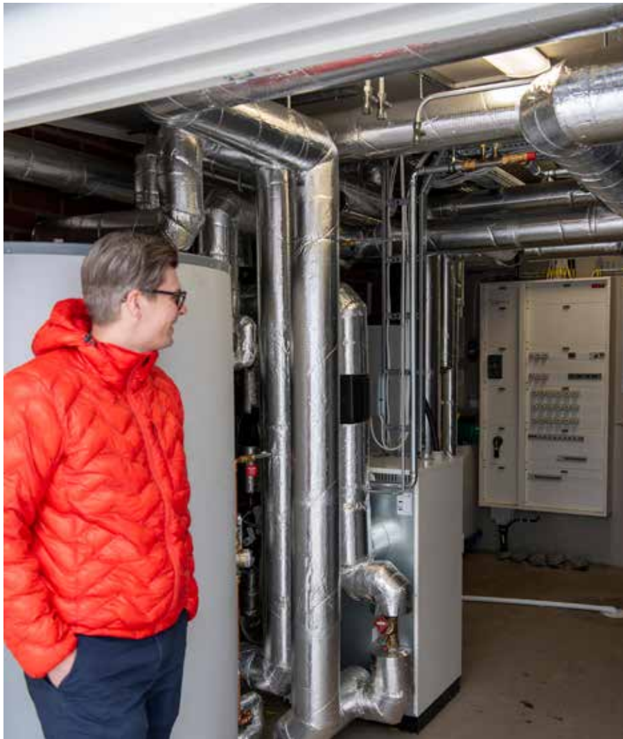
Alexander Sandgren, energiingenjör på Alebyggen, visar det nya teknikrummet för bergvärmarna på Kungsvägen.
