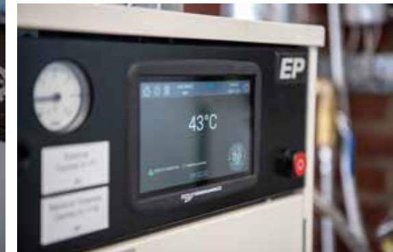
Värmepumpen där vattnet, som ska till radiatorerna, värms upp.
